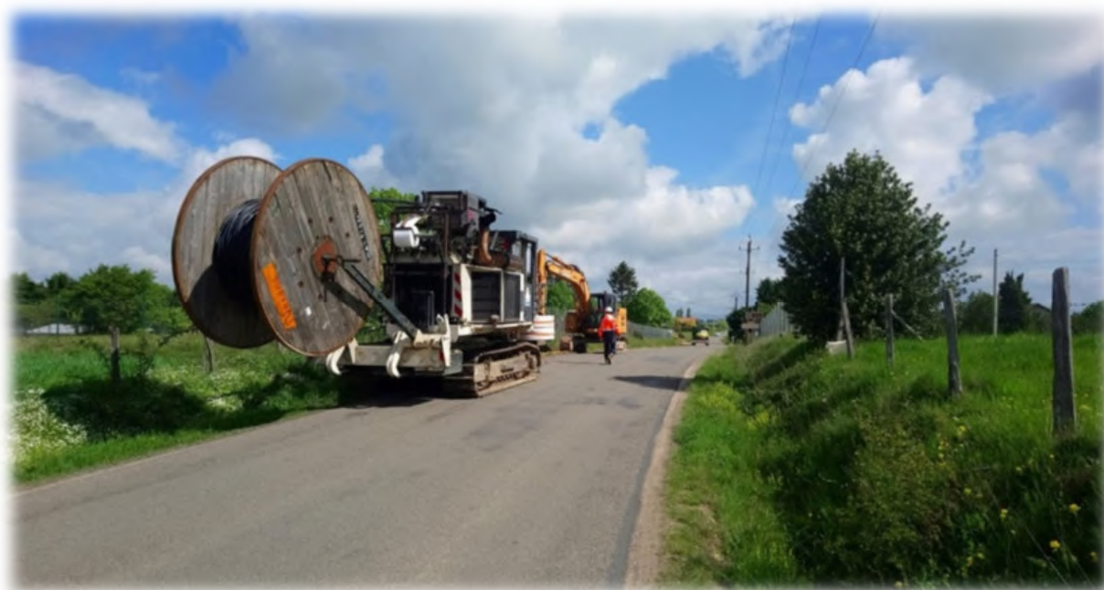
Exemple de chantier d'enfouissement de câble le long d'une voirie (source : sciepd)
